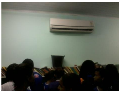
Figura 8: Balde colocado para conter o vazamento do ar-condicionado na biblioteca
