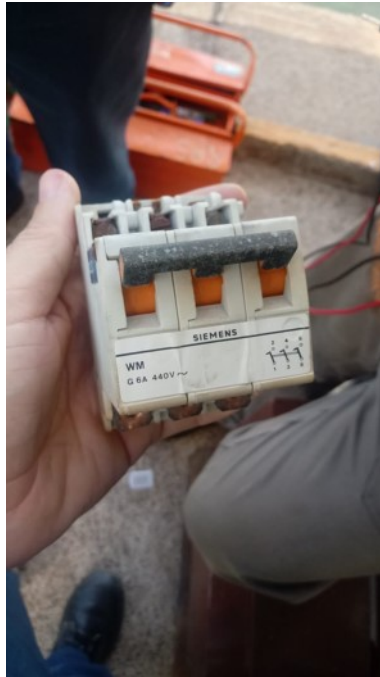
Figura 145 – Oxidação dos terminais do disjuntor dos TPs.
