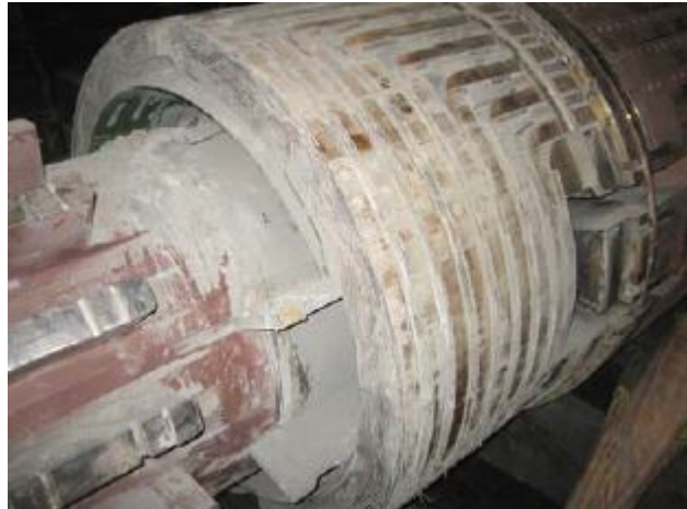
Figura 37 – Rotor contaminado por detritos. Fonte: Moore e Vandenabeele (2009).
