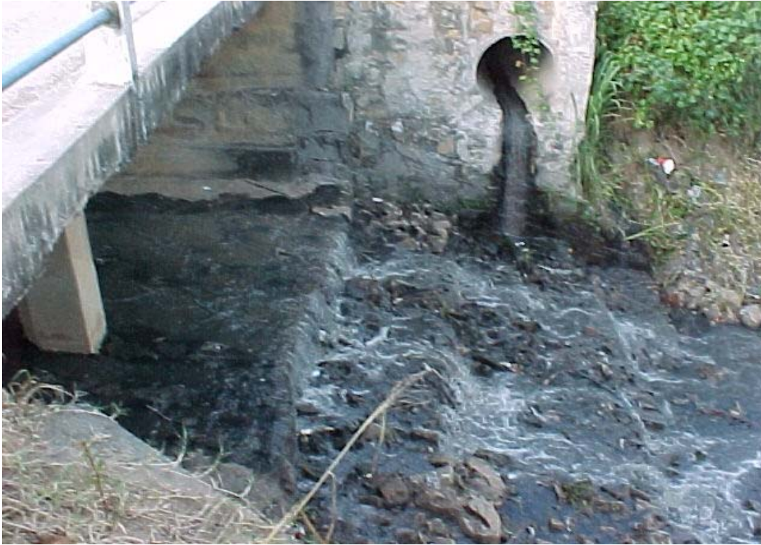
Figura 11. Despejo de esgoto no Riacho do Alambique no município de Senhor do Bonfim.
