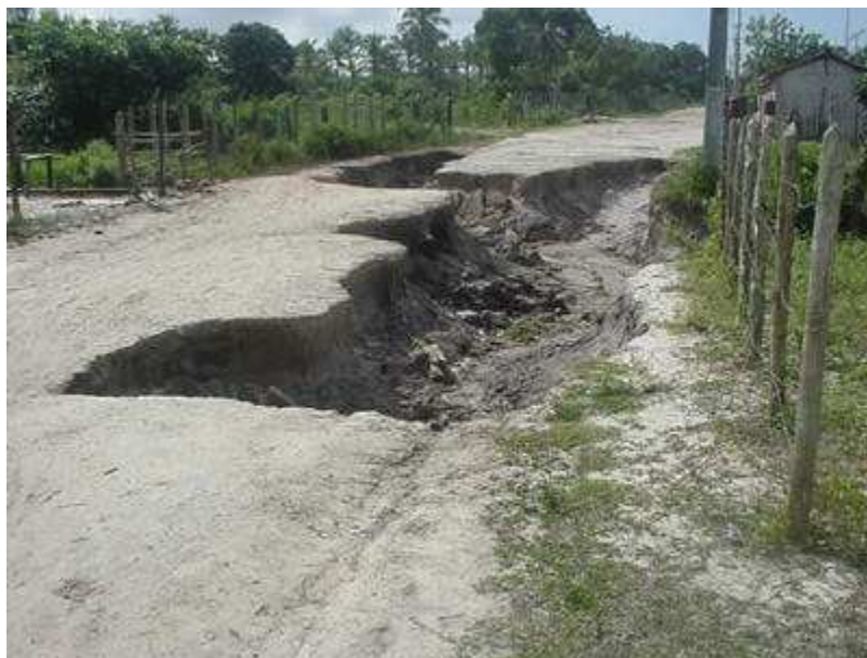
Figura 15 – Estrada de Acesso à Praia dos Garcez (dia 20/06/05)
