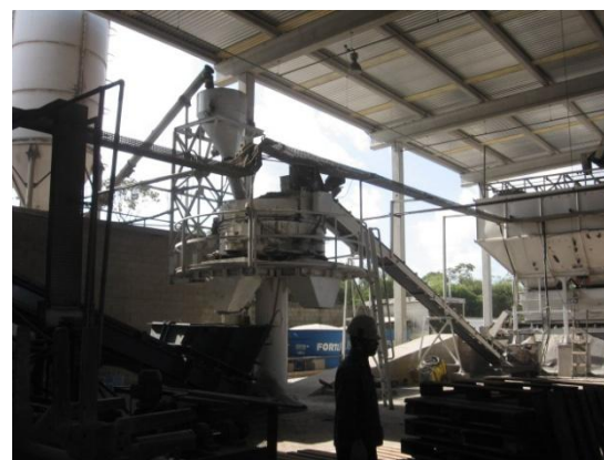
Figura 60: Misturador de Concreto – FPM 04
