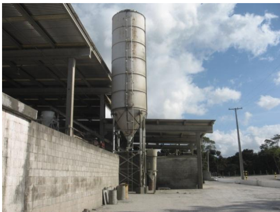
Figura 57: Silo de cimento- FPM 04
