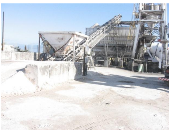
Figura 13: Transporte dos agregados via correia transportadora até os silos de agregados – Central 04
