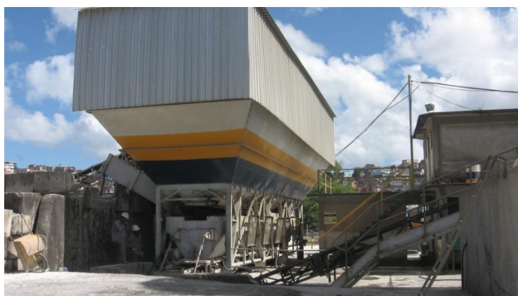
Figura 15: Silo de Agregados
