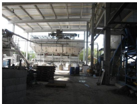
Figura 59: Silo de agregados acoplado com balança – FPM 04
