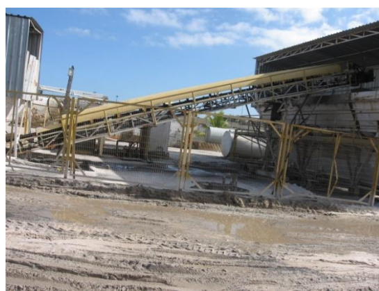
Figura 14: Transporte dos agregados via correia transportadora até os silos de agregados – Central 06
