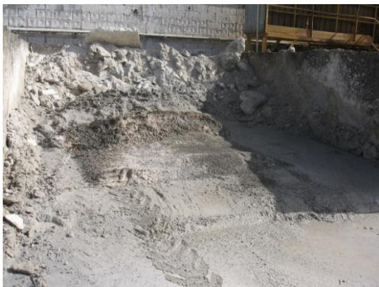
Figuras 37: Baia para armazenar resíduo de concreto na central 03
