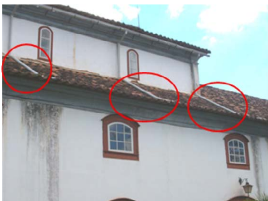
Figuras 5.7. Intervenção inadequada de colocação de condutores
