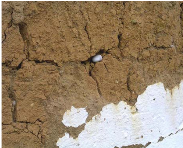
Figuras 5.17. Desprendimento de reboco sobre emboço
