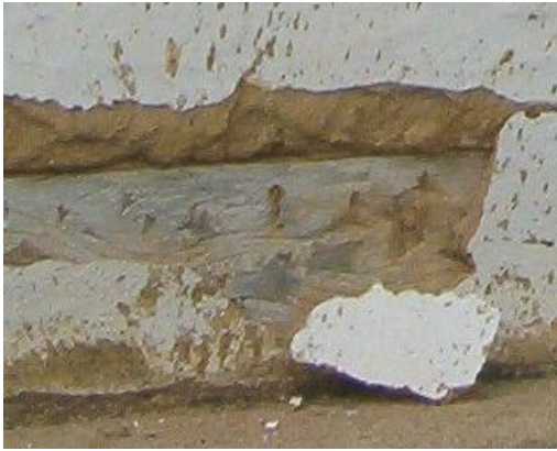
Figuras 5.15. Desprendimento de camada pictórica sobre reboco devido ao desprendimento do reboco sobre a peça de madeira
