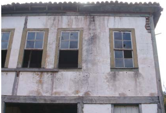
Figuras 5.5. Manchas provocadas pela ocorrência de infiltração descendente
