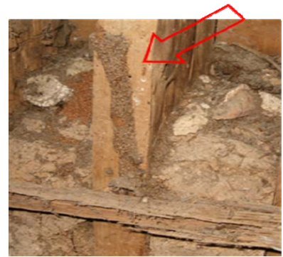
Figuras 5.23. Presença de cupim de solo
