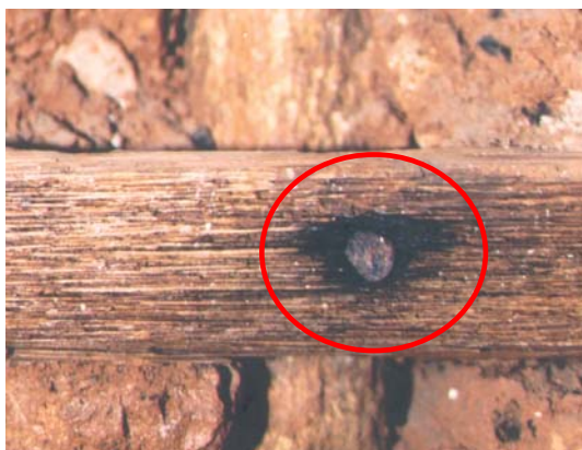
Figuras 5.28. Oxidação do prego na trama
