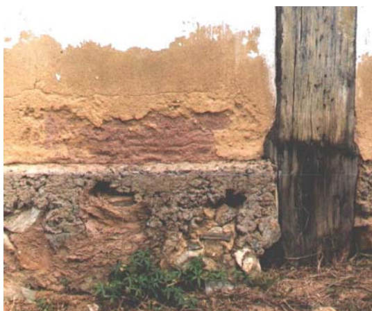
Figuras 5.26. Erosão provocada pela ação da água
