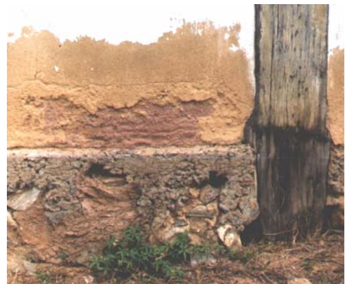
Figuras 5.6. Infiltração ascendente e erosão por respingo de água de chuva
