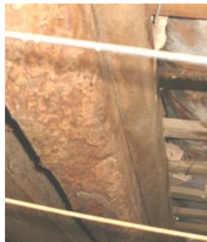
Figuras 5.22. Presença de fungos
