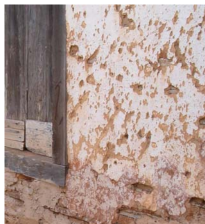
Figuras 5.27. Erosão provocada pela ação do vento
