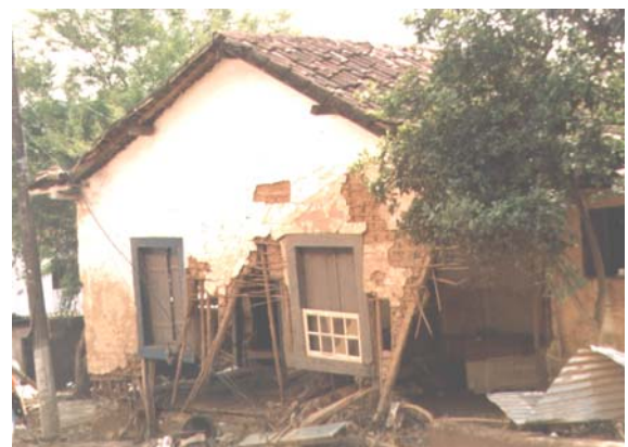
Figuras 5.8. Parte do edifício levado por enxurrada de água de chuva
