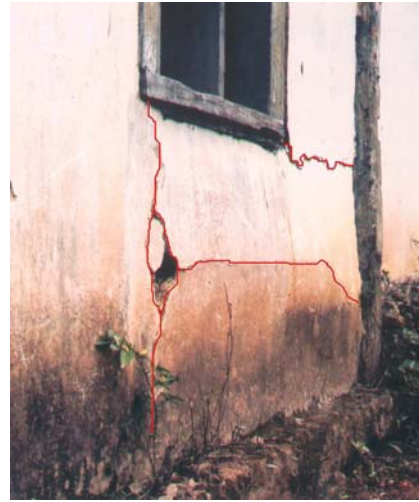
Figuras 5.12. Fissuras no reboco causadas por problemas na estrutura autônoma
