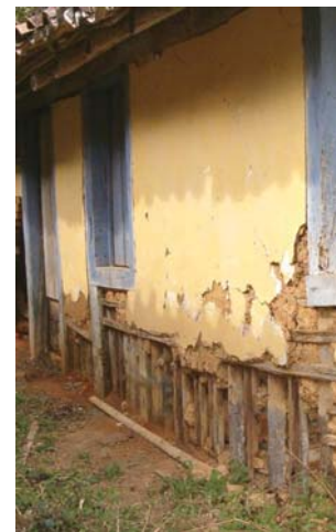
Figuras 5.18. Perda de enchimento das demais camadas da parede
