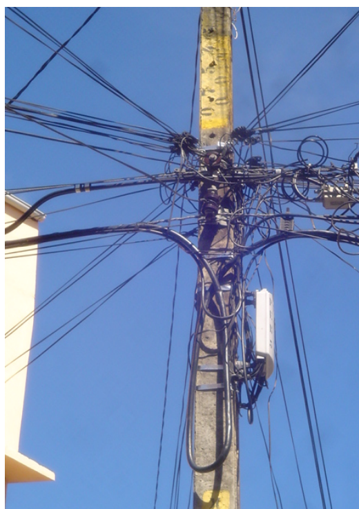
Figura 30 – Poste sustenta um conjunto de redes, TV a cabo, eletricidade e telefone. Fotografia nossa
