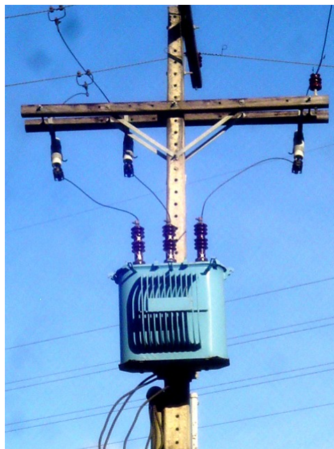
Figura 04 – Linha de distribuição primária e equipamento de redução de tensão. Fotografia nossa.
