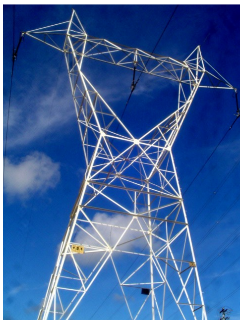
Figura 03 – Linha de transmissão de energia elétrica. Fotografia nossa
