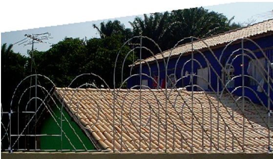
Figura 2 ó Fotografia do gradil radrizado.
