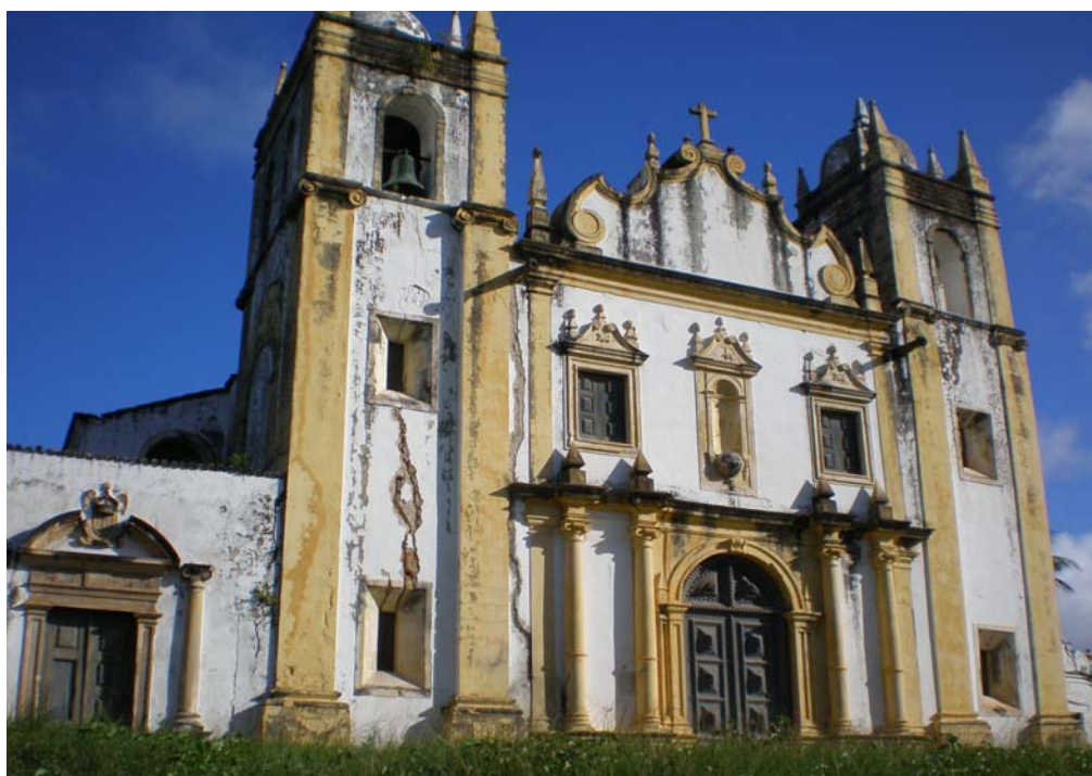
Fotografia 62 – Igreja do Carmo com rachaduras na fachada, 2007 117
