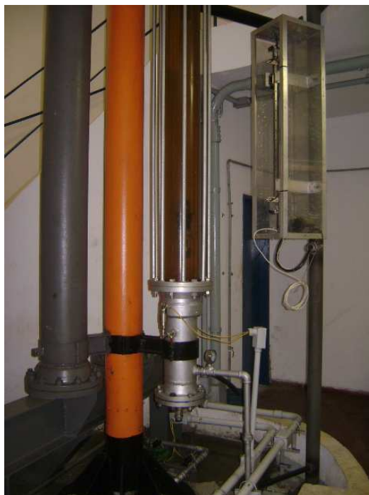
Figura 35 – Fundo do poço do Sistema de Bombeio Mecânico do LEA
