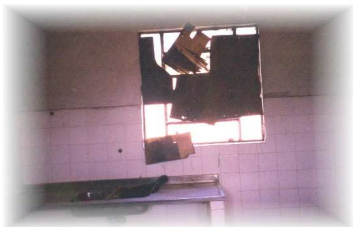
Figura 23: Vista interna da Unidade de Saúde abandonada.
